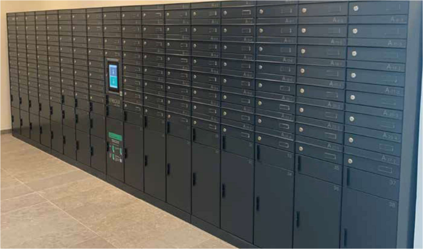
Instalación Univers paquetería + correo
